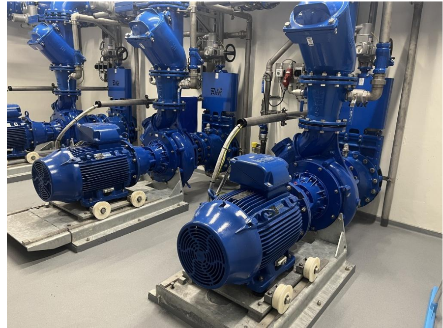
Nieuwe pompen gemaal Kerkstraat
