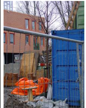
onbeschermd boom bij bouwwerkzaamheden
