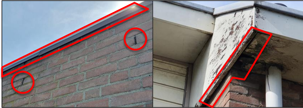
Figuur 4 De kierende daklijsten, open stootvoegen en rotte boeiboorden van de bebouwing op de planlocatie.
